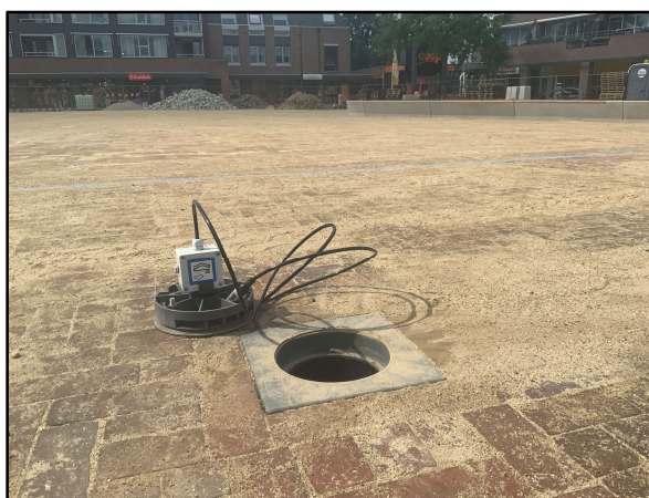
Communicatie module met waterlevel sensor aan het putdeksel
